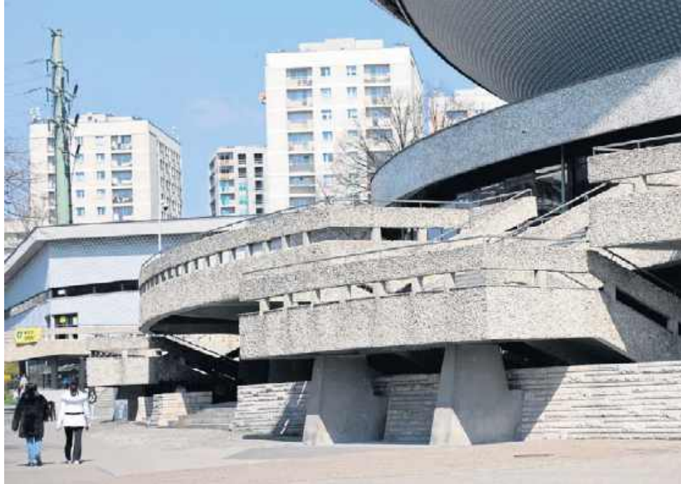
Ekspertyzy potwierdzają uszkodzenia tarasów i schodów, wskazują przyczyny
