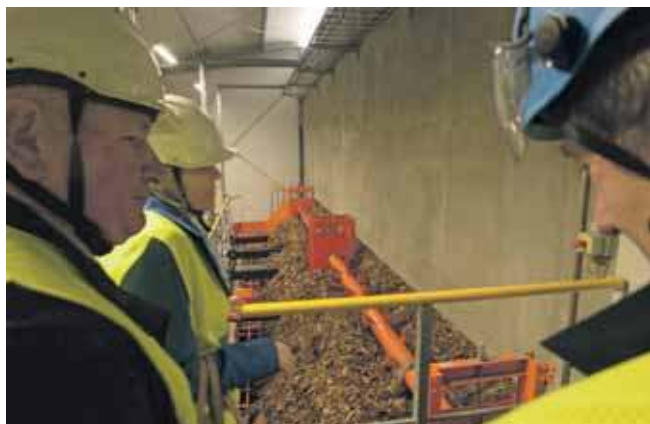
Instalacja oparta jest m.in. o kotłownię opalaną paliwem biomasowym leśnym
