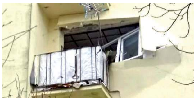
Eksplzja uszkodziła fragment elewacji bloku
