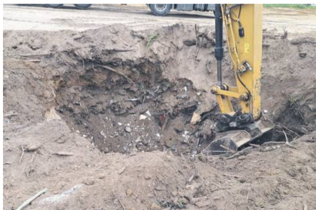
Właściciel terenu został zobowiązany do natychmiastowego usunięcia zakopanych odpadów
