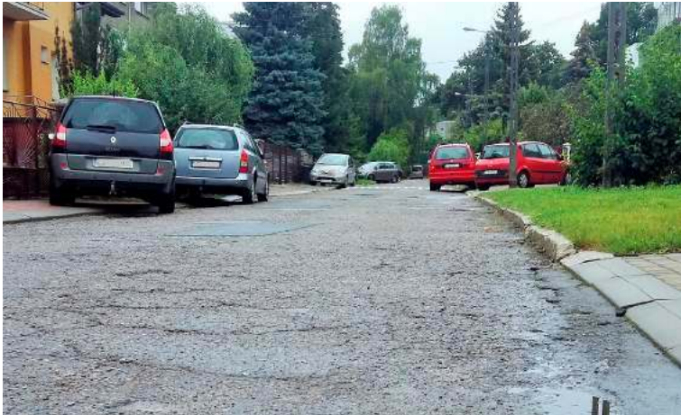
Ulicy Zuchów na pewno przyszedłby się remont, ale nie brakuje głosów, że inne ulice wymagają pilniejszej naprawy
