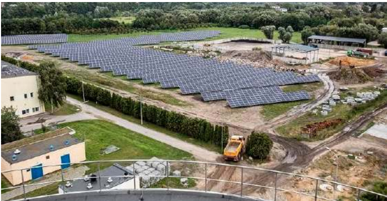
Instalację tworzą 6552 panele monokrystaliczne rozmieszczone na obszarze ok. 4 hektarów
