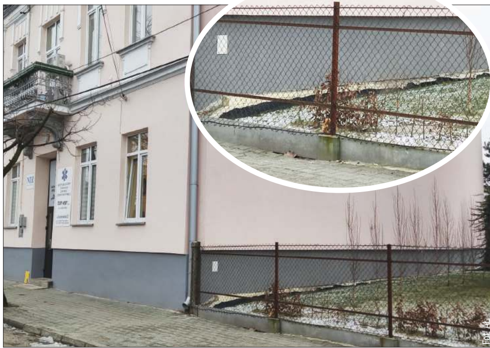
Spór trwa, a niedokończone prace elewacyjne powodują nasiąkanie fundamentów oraz niszczenie elewacji.
