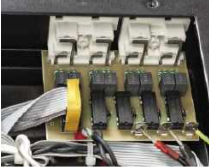
Sygnal ze źródeł przełączają ciche kontaktrony, umieszczone na niewielkiej płytce obok gniazd RCA.
