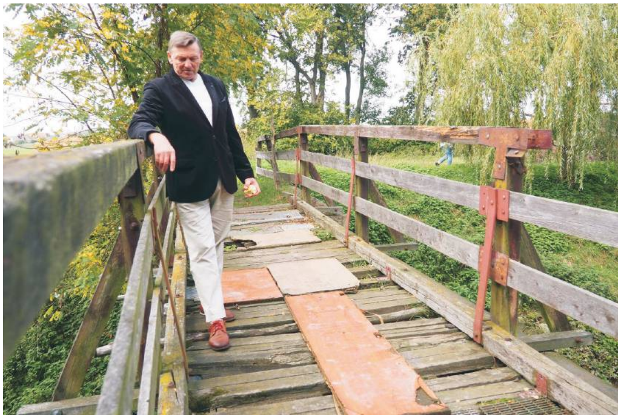
Stan kładki jest fatalny. Przez dziurawą podłogę można wpaść do rzeki
