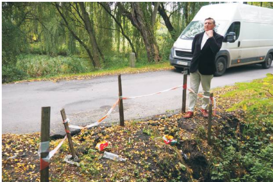
Zdaniem mieszkańca, niezabezpieczony jest też przepust przy oczku wodnym
