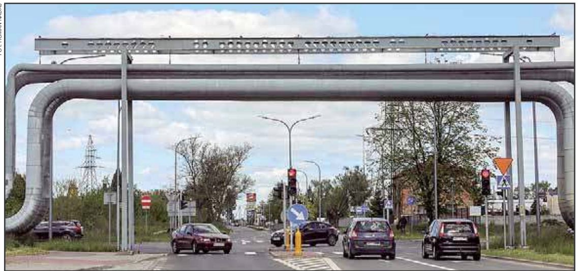
Dzięki tej inwestycji z krajobrazu miasta mają m.in. zniknąć napowietrzne sieci ciepłownicze, jak ta na zdjęciu z ul. Niechodzkiej
