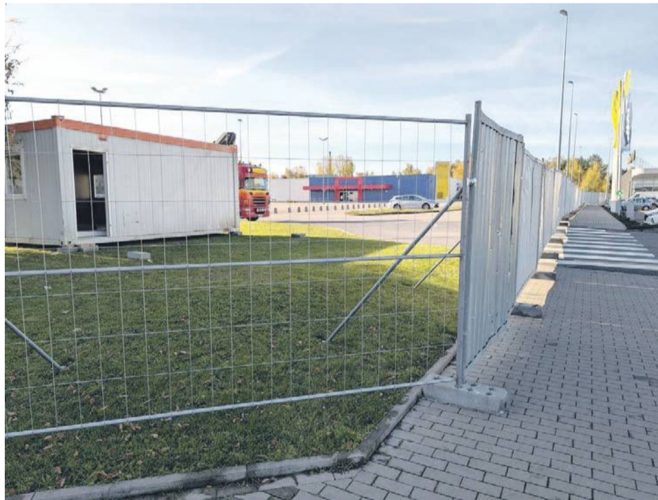
Przekazanie placu budowy odbyło się z końcem października, pierwsze prace rozbiórkowe zostały już rozpoczęte
