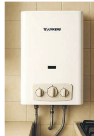
Bierze wodę, pryska nią pod junkers, robi się płama, potem zdejmuję obudowę kuchenki i mówi, że piec cieknie
