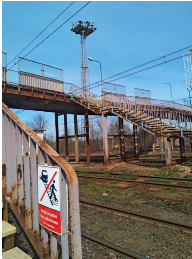
Kto zajmie się remontem kładki kolejowej?
