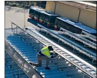
Panele na budynkach bazy MZK już są, a będą też stacje transformatorowe i magazyn energii
