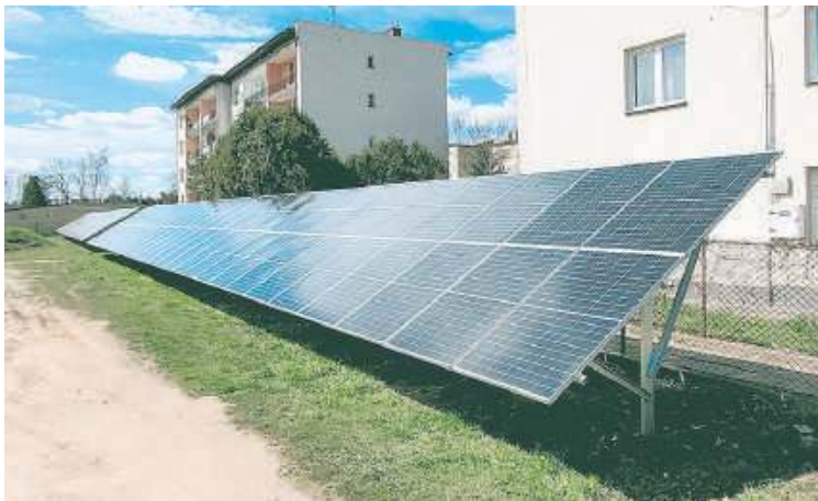
W stacji wodociągowej w Jabłonce Lackiej już łapią słoneczną energię.
