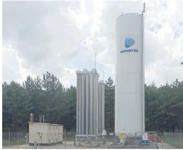
Instalacja gazowa Novatek niedaleko Mrozów fot. G. Wajs
