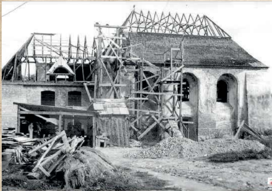
Duża Synagoga w Łęcznej. Zbudowany w XVII wieku budynek w XIX stuleciu dwa razy padał ofiarą pożarów. W czasie II wojny światowej zupełnie zdewastowany przez Niemców. W 1952, wobec pogarszającego się stanu technicznego i notorycznego rozkradania, postanowiono o rozbiorce, ale nawet na nią zabrakło pieniędzy, zaczęto więc remont, który potrwał 12 lat. W jego trakcie w miejsce oryginalnego babińca (z lewej) zbudowano zupełnie nowy.
