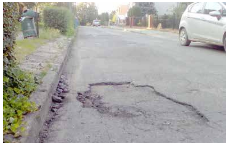
Olbrzymia dziura od dłuższego czasu aż woła o naprawę jezdni
