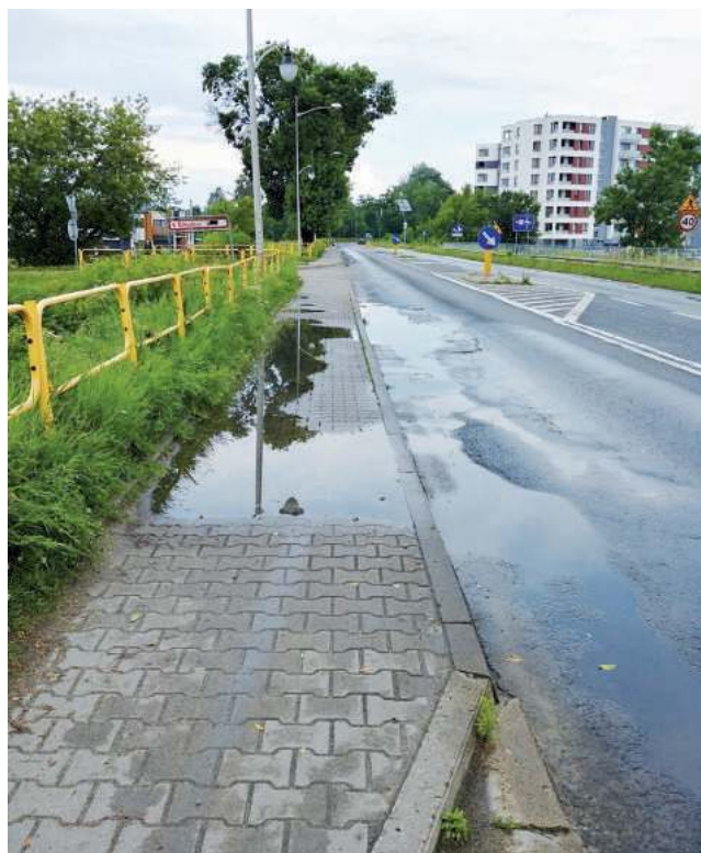
Ulica Morawicza, która wymaga poprawy nawierzchni
