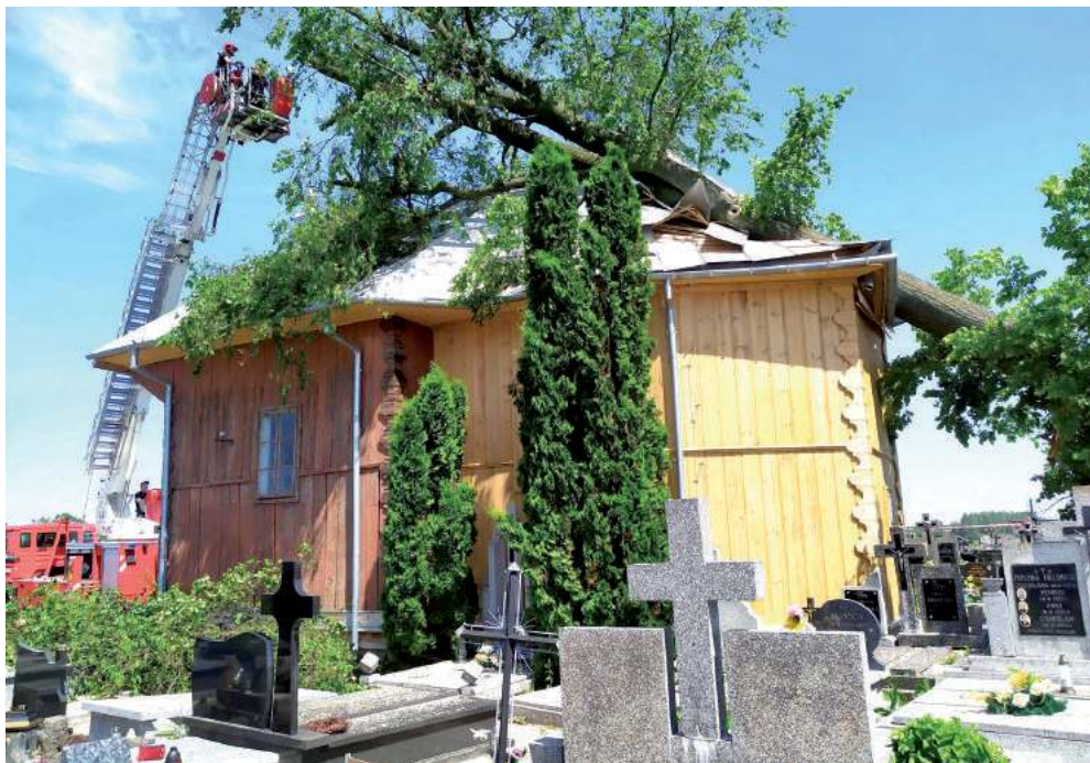
Drzewo uszkodziło dach niedawno wyremontowanej kaplicy na cmentarzu w Trzebieszowie
