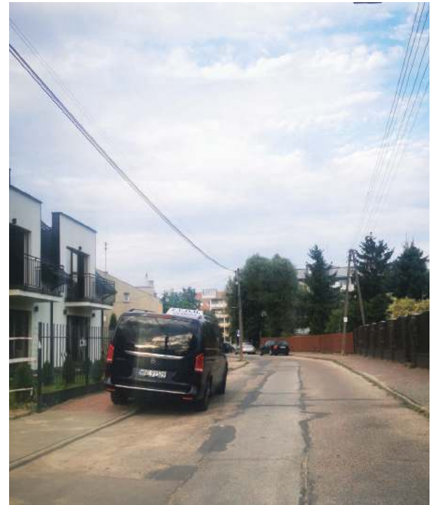
Ul. Lotników - „gołym okiem” widać, że wymaga remontu
