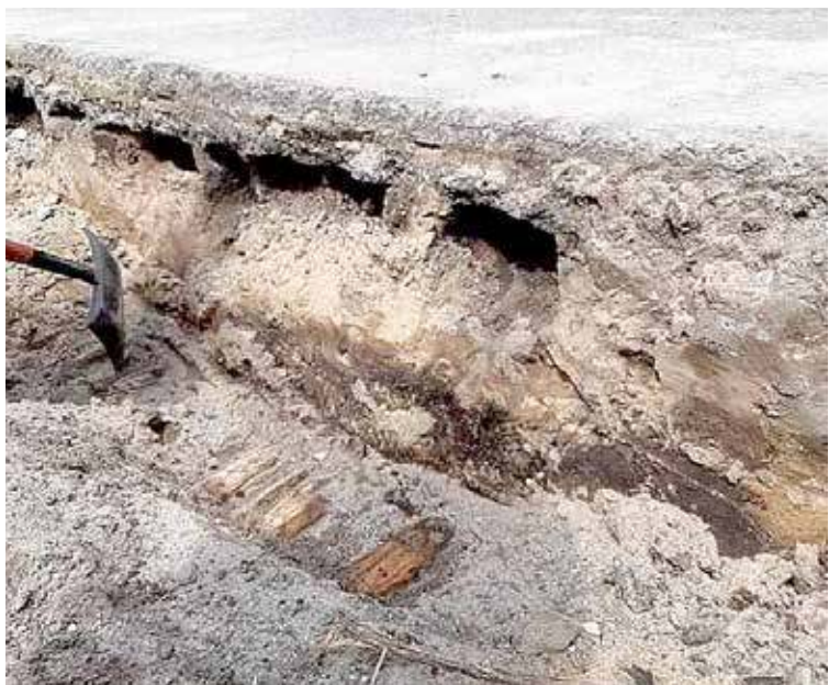
Fragment drewnianego wzmocnienia nasypu drogowego
