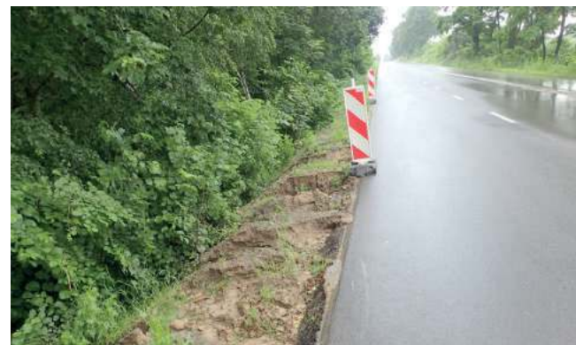
Ubiegłotygodniowe opady deszczu zmyły pobocza drogi
