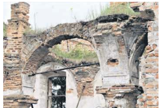
Pozostałości wnętrza synagogi w Łaszczowie.
