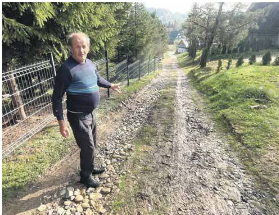
Franciszek Biel od 15 lat zabiega w gminie o remont drogi.
