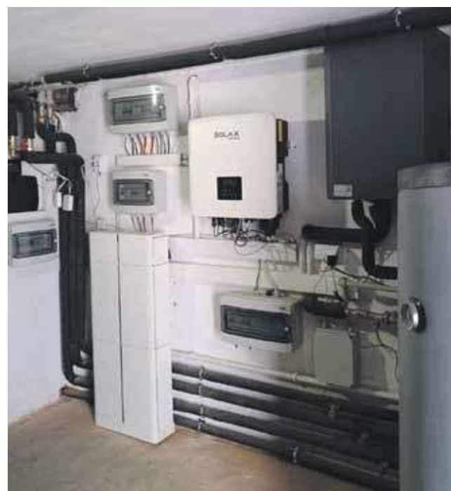
Tak wygląda nowoczesna kotłownia w domu Haliny Kryjak.
