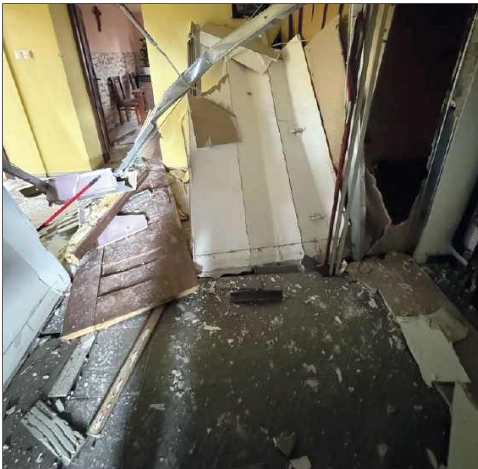
Zniszczony dom w Pławie.
