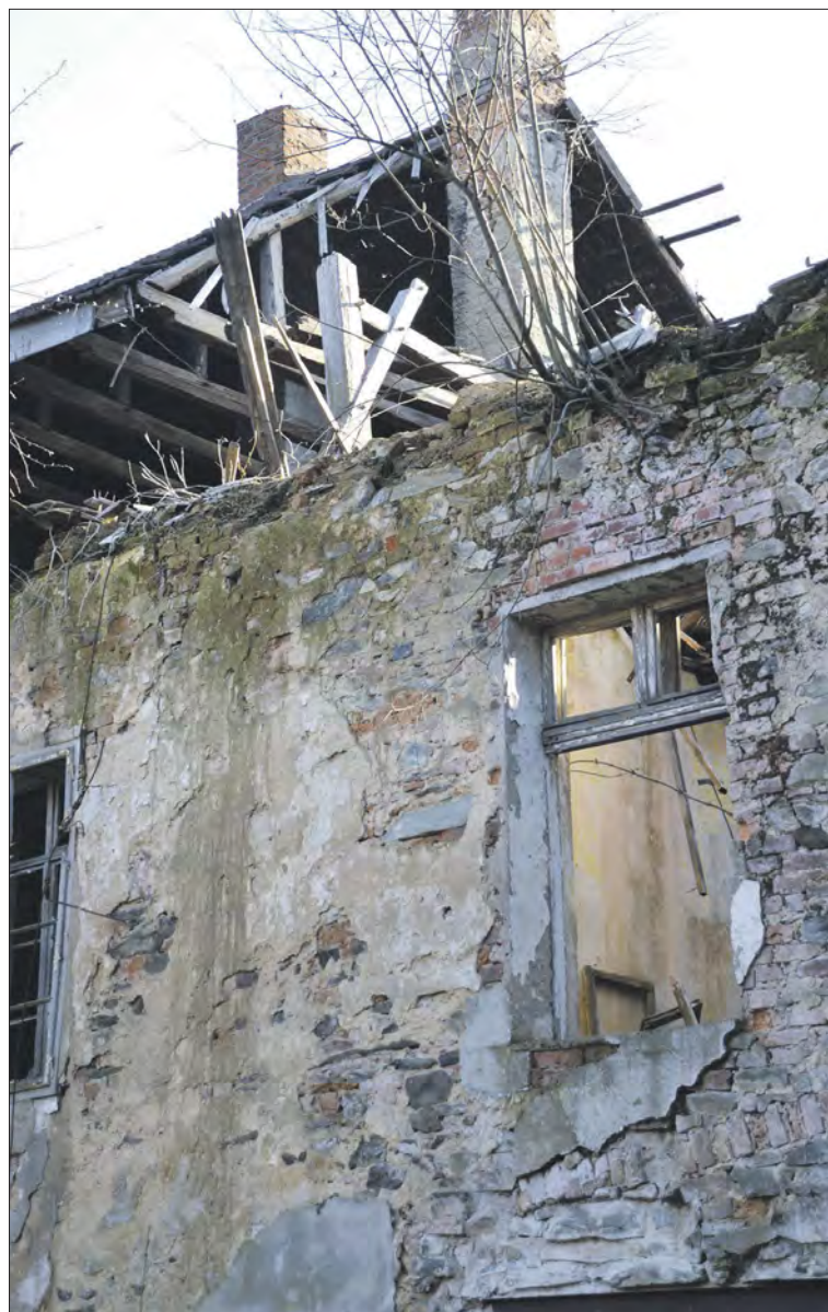
W skrzydle zamku od strony dawnego folwarku zawalił się dach
