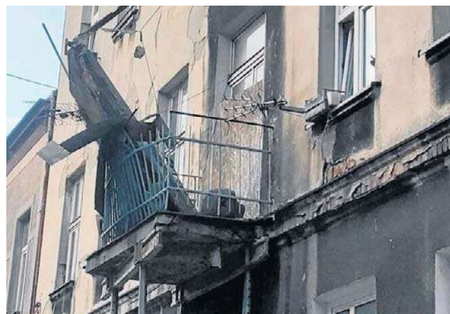
W protokole kontroli technicznej obiektu z 2020 roku wykazano na konieczność naprawy balkonów
