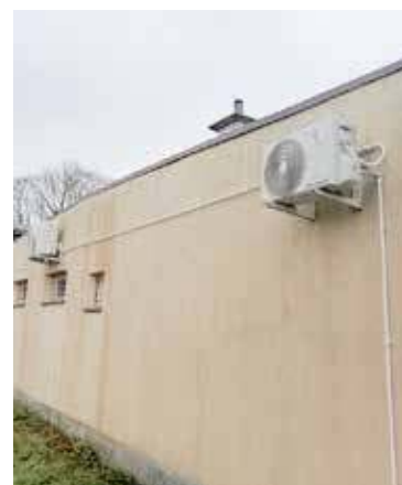
Pompy ciepła zapewnią remizie ciepło (fot. Gm. Stepnica)
