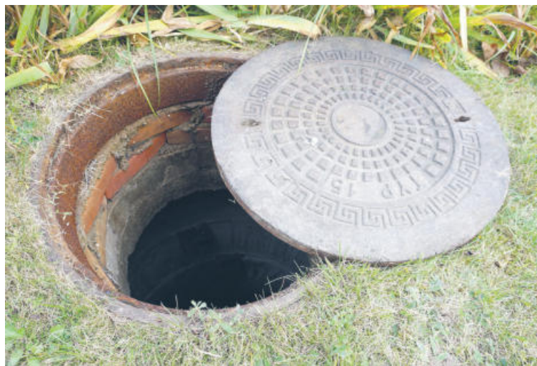
Uchylone studzienki mają pomóc w tym, by smród nie dostał się do domu.
