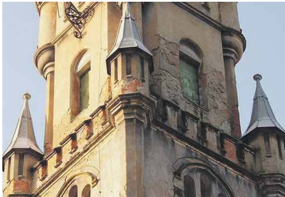
Sypiąca się wieża ma być wyremontowana i przywrócona do pierwotnego wyglądu
