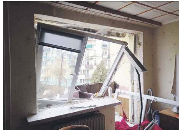
W wyniku wybuchu wypchnięte na zewnątrz zostały okno i drzwi balkonowe
