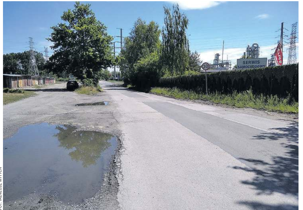
Nawierzchnia drogi wykazuje znaczne ubytki oraz deformacje, brak jest właściwego odprowadzenia wody opadowej, co powoduje uszkodzenia nawierzchni oraz poboczy
