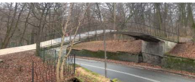
Kładka znajdująca się w sąsiedztwie Parku Czarotoryskich wymaga remontu. Jeśli w przetargu uda się wyłonić wykonawcę, prace ruszą jeszcze w tym roku
