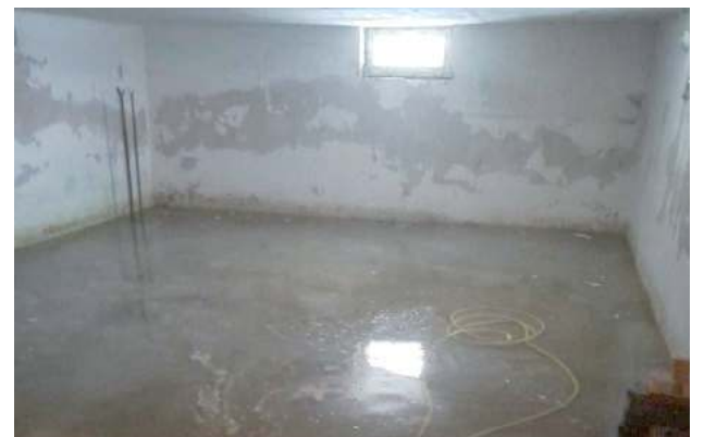
Radny Janusz Gnida bije na alarm, że w piwnicy remontowanej remizy w Lipowcu stoją wody gruntowe. - Wpadł na pomysł, jak zlikwidować kolejny budynek gminny, jakim jest remiza, żeby nie można było go użytkować w sposób nieuciągliwy – mówił radny o działaniach wójta
