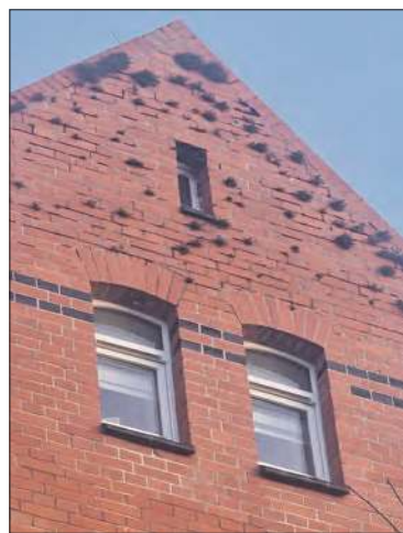
Mech porastający elewację budynku
