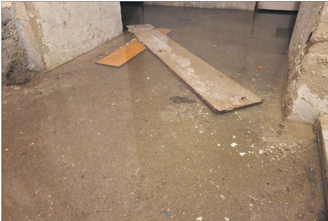
Woda w piwnicy
