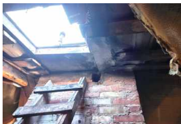
Działania przybyłych strażaków polegały na wycięciu nadpalonych elementów dachu i wyniesieniu ich na zewnątrz budynku
