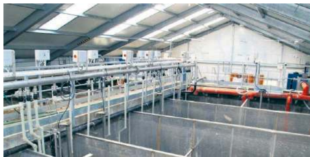
Latem, gdy przyjeżdżają turyści, zrzut ścieków jest tak duży, że oczyszczalnia musi pracować na maksymalnych obrotach.
