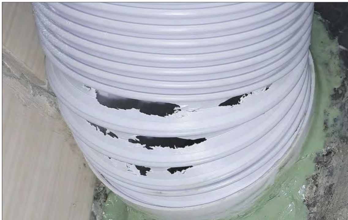
Szczury z łatwością przegryzają wytworzone z miękkiego materiału rury kanalizacyjne
