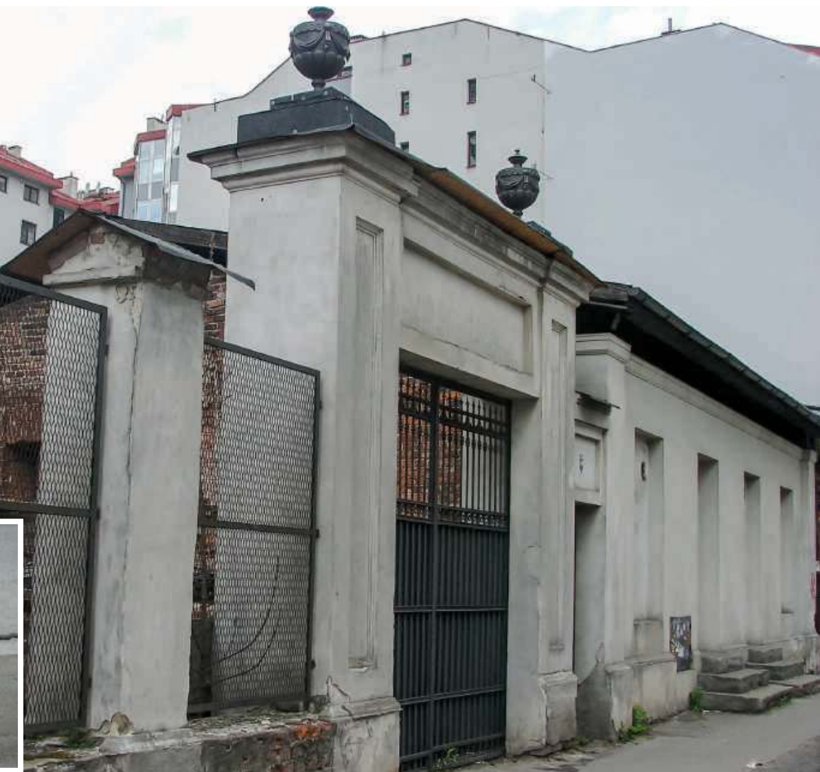
Zespół zabudowy przy ul. Żelaznej 63 i destrukcja murów bramy, odnowionej w 2009 r. | fot. Janusz Sujecki/Gazeta Polska
