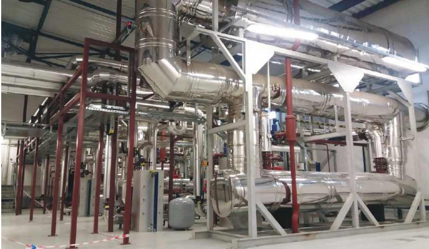
Odzysk ciepła z kogeneracji
