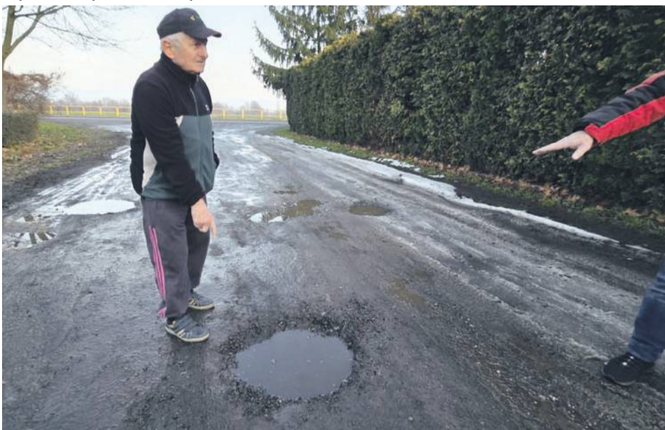
Wysypywanie tłuczni czy frezofiny - zdaniem pana Kazimierza - nie ma większego sensu, bo drogą jeździ ciężki sprzęt na pola i już po kilku przejazdach powstają kolejne dziury
