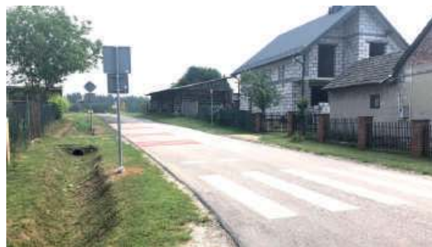
Przejście dla pieszych na drodze powiatowej w Bukownicy prowadzące wprost do rowu
