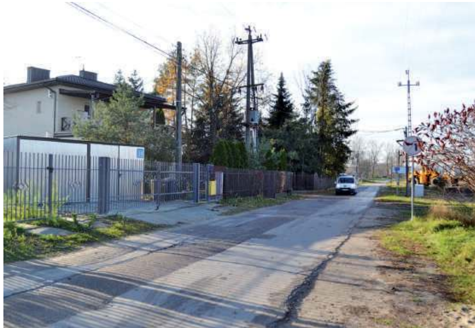
Ul. Mała wymaga gruntownej przebudowy
