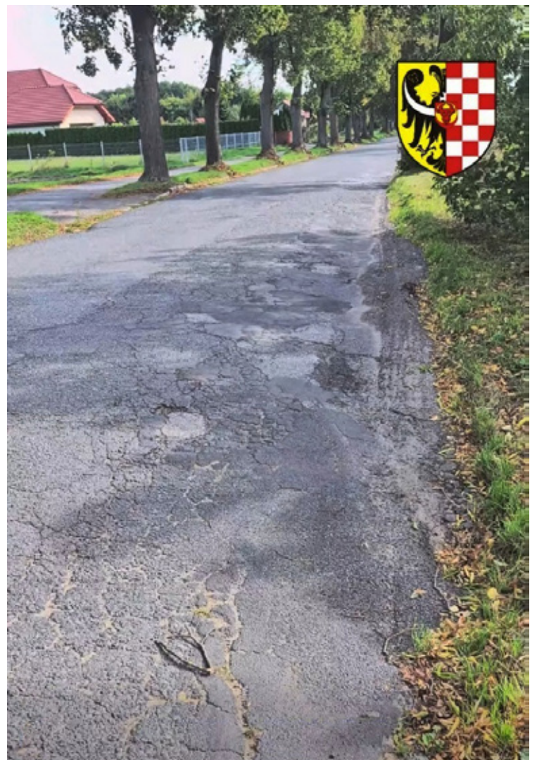
Ul. Willmana w Lubiążu przeznaczona do remontu.
