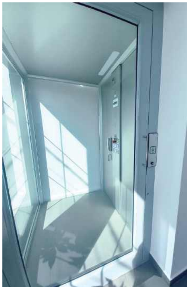
W budynku zamontowano windę
