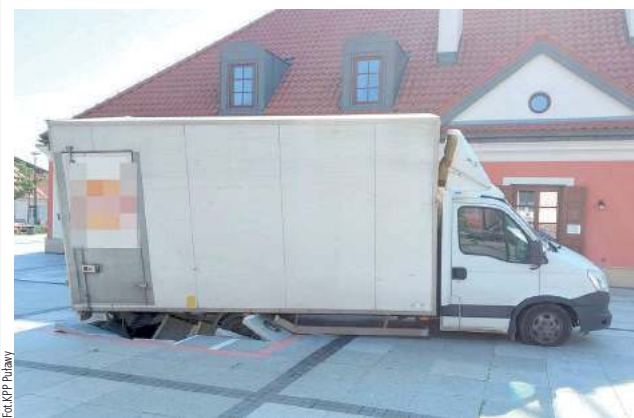
Pod ciężarem dostawczego samochodu płyty ustąpiły. Pod spodem była instalacja znajdująca się na rynku fontanny
