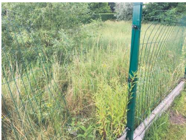
Zniszczone ogrodzenie boiska w Myślachowicach
