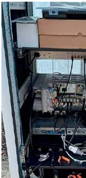
Serwis przemiennika M17 – wnętrze wolno stojącej szafy rack
