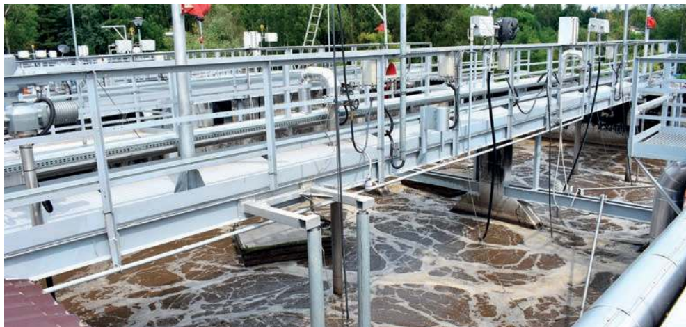
Oczyszczalnia ścieków w Libiążu. FOT. WODOCIĄGI CHRZANOWSKIE
