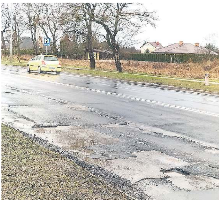
Ulica Włodawska od dawna aż prosi się o gruntowny remont
