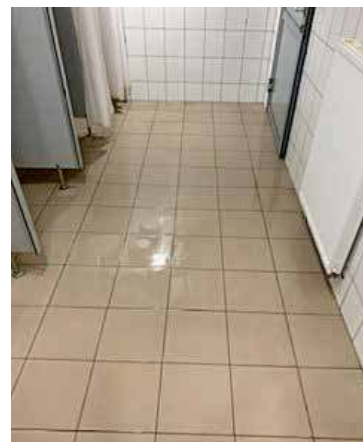
Woda z natrysków zalewa dosłownie całą łazienkę
