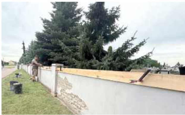
Fragmenty ogrodzenia są bardzo zniszczone, inne pozostają w niezłym stanie. Roboty już trwają
